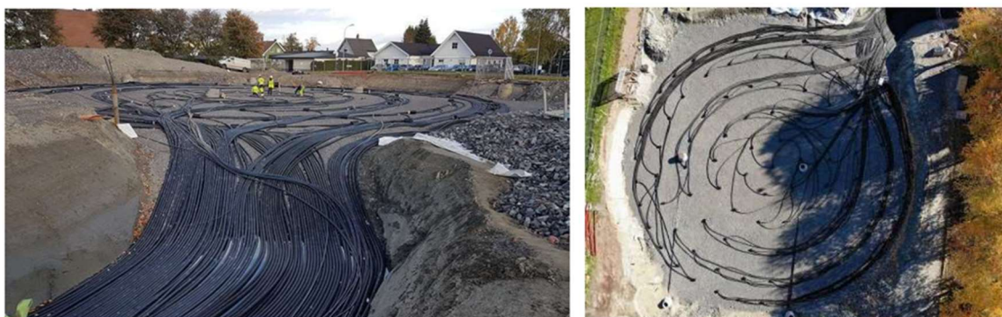
Figur 73: Projekt Geotermos, Drammen, Norge. Borrhålslager med anslutning av slangar. Foto Randi Kalskin Ramstad
