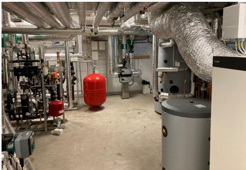
Bild 1. Bild på undercentralen i kvarteret Hyttkammaren med värmepump (t.h.) som används för att värma tappvarmvatten, värmen tas från returvärmen som också används för rumsuppvärmningen. Ackumulatortanken är för tappvarmvattnet.
